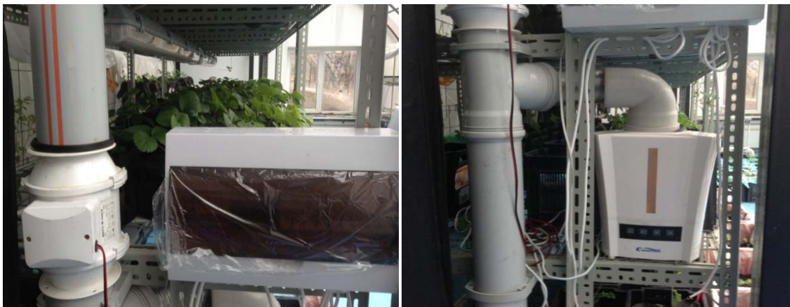
Фото 3 – Вентилятор регулирования газовой среды (фото слева). Аппарат «холодного пара» и ионизации воздуха и (справа)
