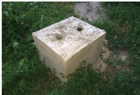
Рисунок 3 – Железобетонная колонна с 2-мя шпурами для ввода газогенератора работающего в режиме дефлаграционного горения
